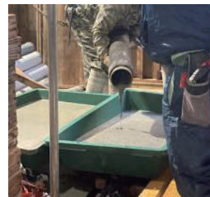
写真-9 先送りモルタル廃棄状況
