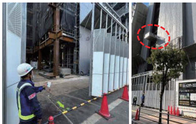
写真-3 メイン(電動)ゲート
