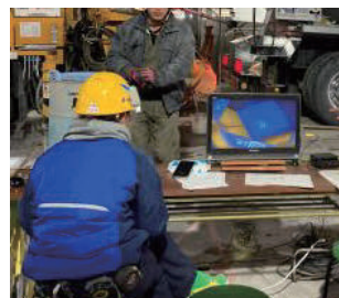
写真-11 CCDカメラによる監視状況
