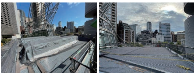
(b) 仮設開口部 (c) ガルバニウム鋼板折版屋根 写真-2 建物上面
