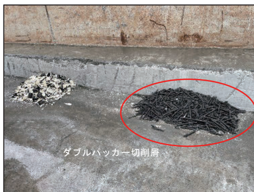
写真-3 地上に排出されたCFRP筋
