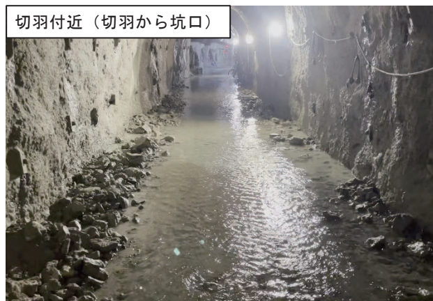
写真-1 坑内冠水状況
