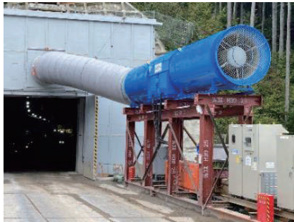
写真-1 換気ファン (220kW)
