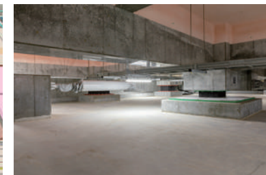
免震装置の設置状況
