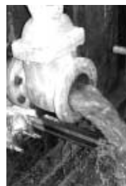
通水管からの地下水流出状況
