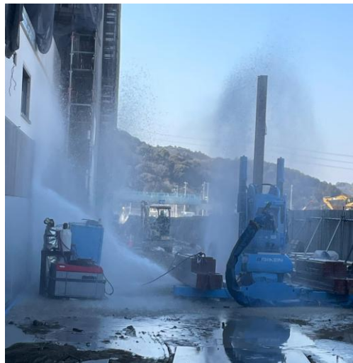
2024年2月 名古屋支店建築 土留め鋼矢板施工中に水道管破損
