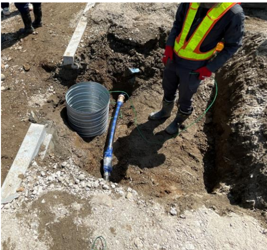
2025年4月 名古屋支店建築 公道照明工事中に水道管破損
