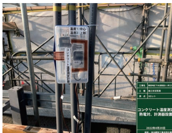
写真-5 温度計の設置状況
